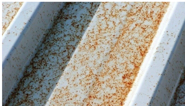
Rys. 35. Uszkodzenia powłoki lakierniczej od pozostawionych porzewiających opiół
