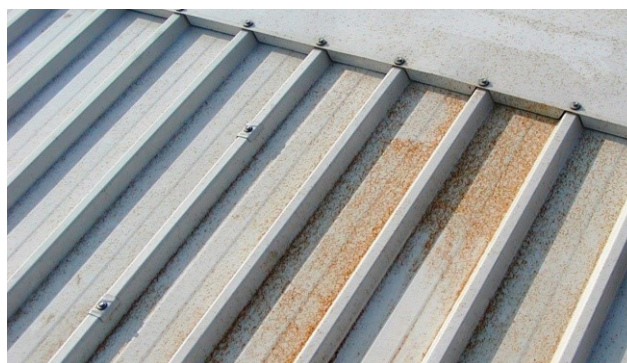
Rys. 34. Widok powłoki lakierniczej uszkodzonej przez opilki podczas cięcia szlifierką kątową
