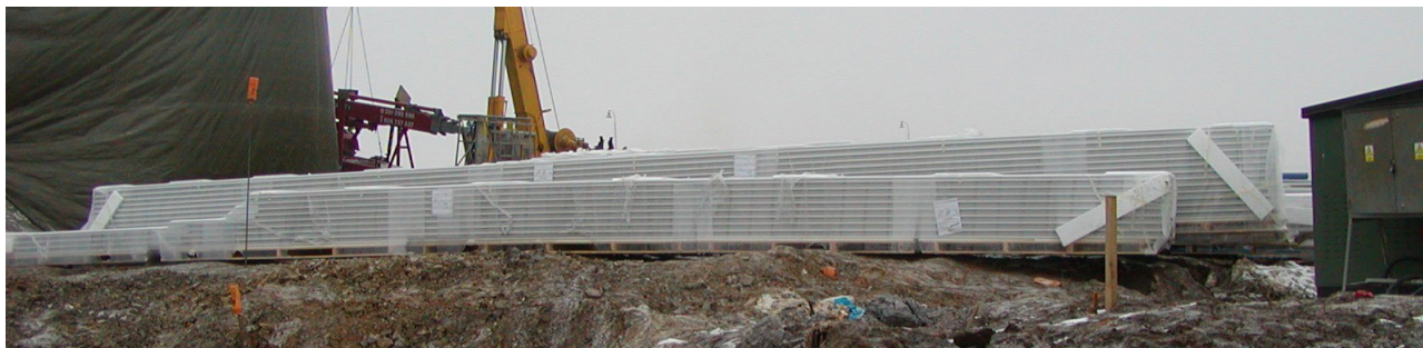
Rys. 9. Nieprawidłowo składowane płyty.
